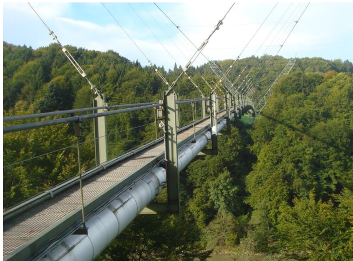
Die Inn-Brücke des OMV-Pipeline-Systems nördlich der Inn-Staustufe Teufelsbruck wird in den Jahren 2024/2025 saniert.
